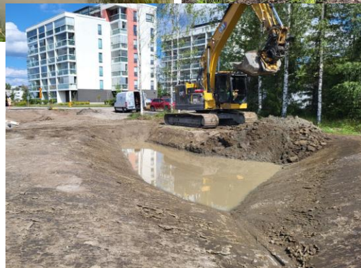
Horsmatien vanha tilanne ja alueelle rakennettu vanematkanpuiston allas sekä Sävelpuiston hulevesien viivytys altaan rakentamista
